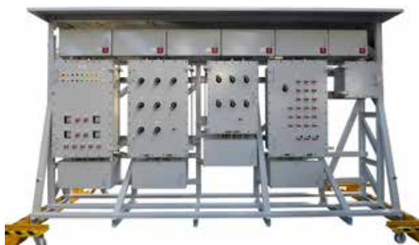
Ex de Switchrack
